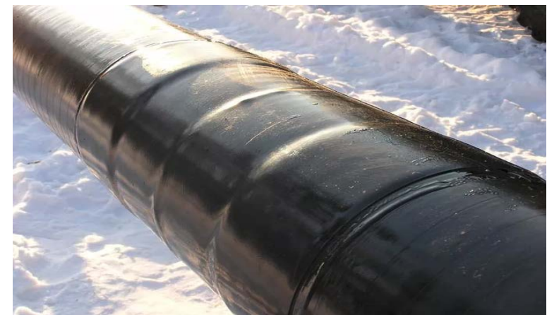
изоляция переходов «земля-воздух»
